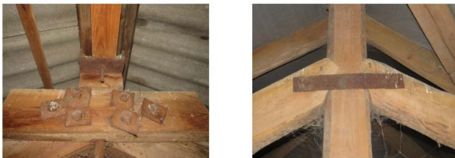
Рис.6. Корозія металевих елементів з'єднань
