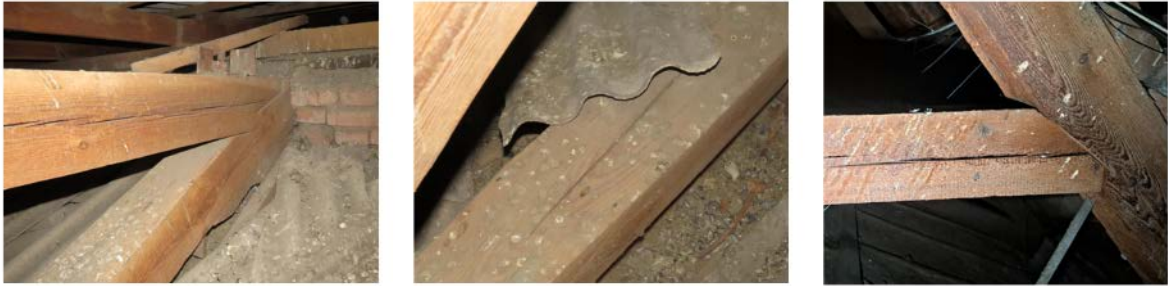
Рис.5. Тріщини від усушки деревини на елементах ферм
