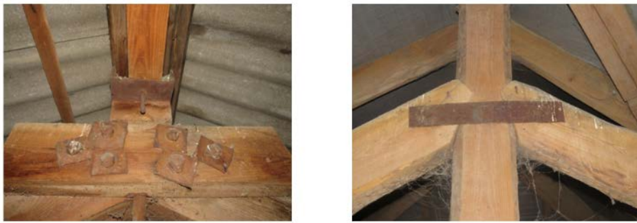
Рис.6. Корозія металевих елементів з'єднань
