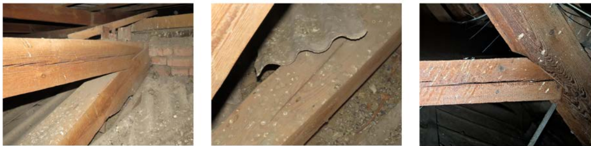
Рис.5. Тріщини від усушки деревини на елементах ферм
