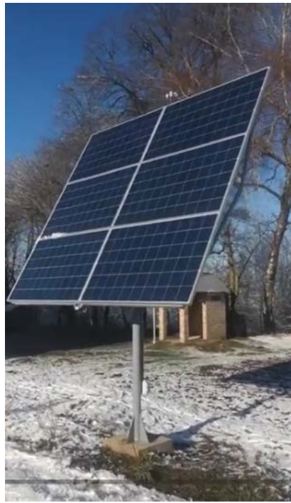
Рис. 10. Загальний вигляд наземної фотоелектричної установки на металевій опорній конструкції.
