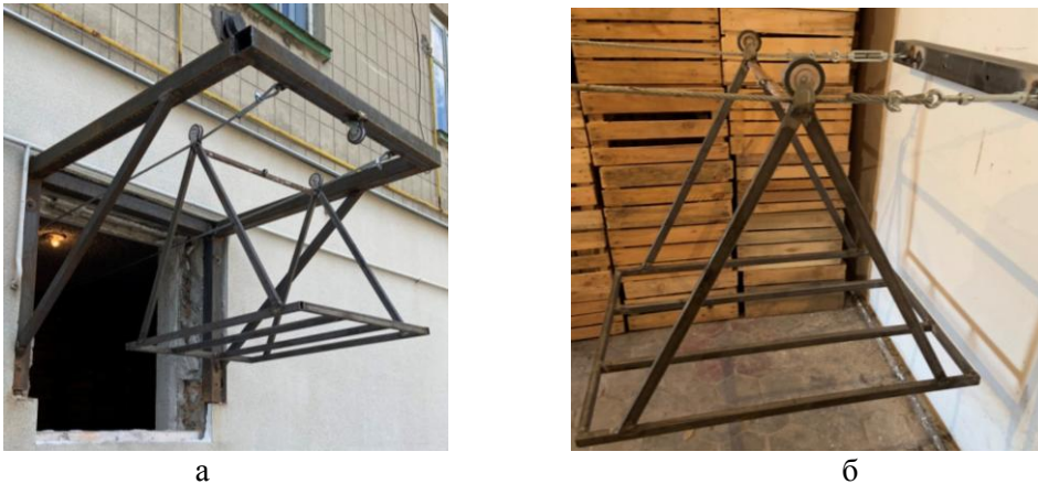
Рис. 2. Загальний вигляд верхньої (а) та нижньої (б) опор
