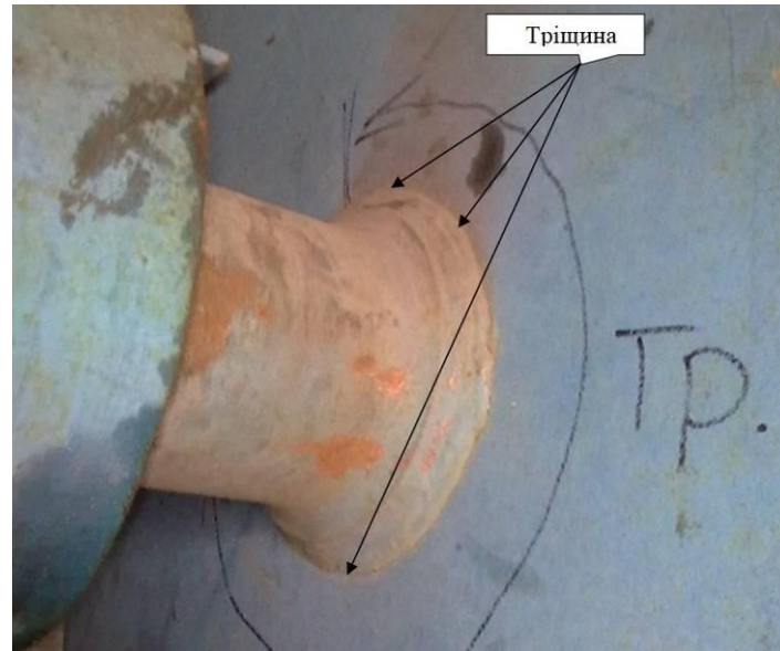
Рис. 1. Ділянка стінки лебідки з утвореною в ній втомною тріщиною (вказано стрілками)
