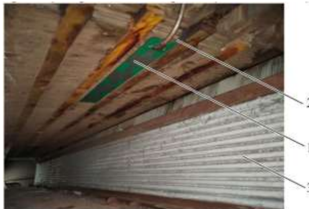
Рисунок 2 – Розміщення сенсора ПП: 1 - сенсор ПП; 2 - зубець розточення статора; 3 - полюс ротора.
