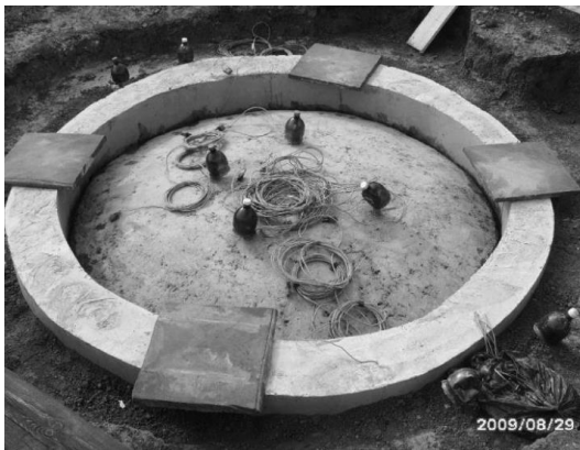
Рис. 4. Загальний вигляд шарнірного Ф-О діаметром 2,4 м
