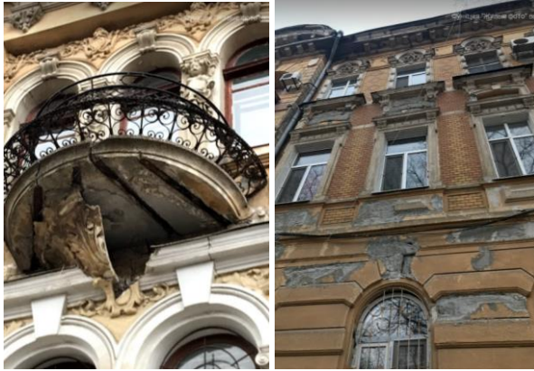
Рис. 4. Памятник архитектуры - Доходный дом Кефала, ул. Марзалиевская 44 и Марзалиевская 38. Разрушение лепнины
