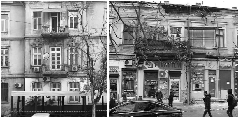
Рис.4. Обвалення балкону на перехресті вулиць Буніна і Канатна та ремонтні заходи старого будинку на розі Садової і Торгової вулиць
