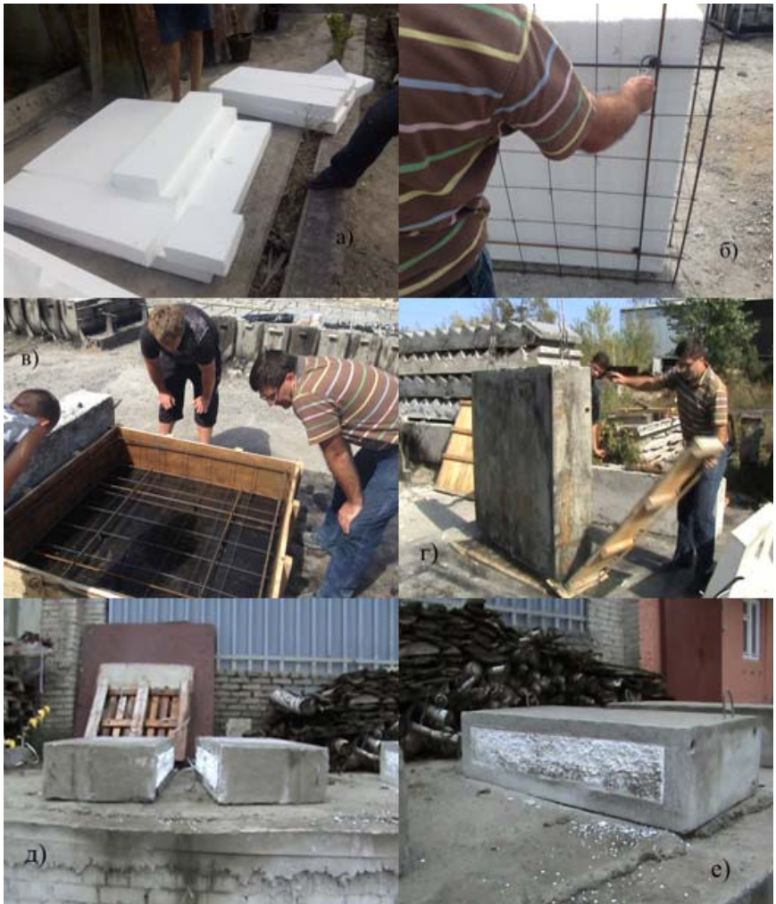
Рис. 1. Бетонирование облегченных конструкций с применением СУБ в одну стадию в два слоя: а) – изготовление вкладыша; б) – сборка арматурного каркаса с вкладышем для вертикального элемента; в) – сборка арматурного каркаса для горизонтального элемента; г) – распалубка вертикального элемента; д) – разрезка вертикального элемента; е) – разрезка горизонтального элемента
