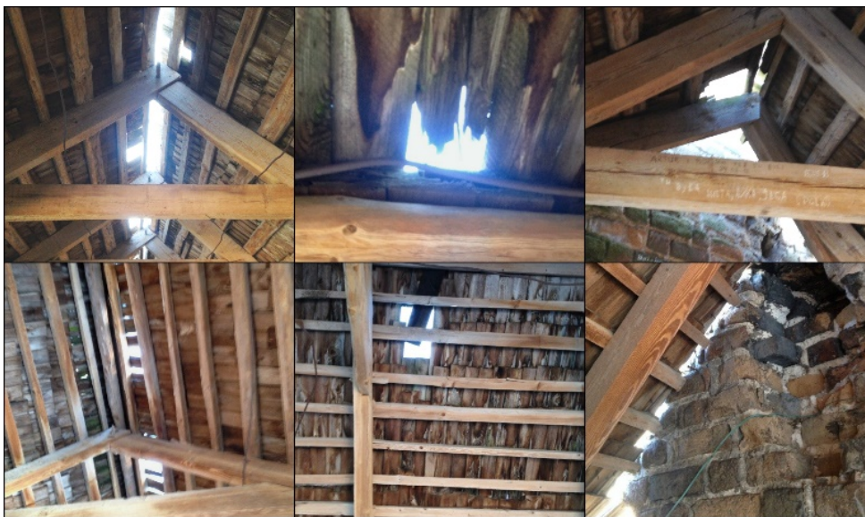
Рис.4. Проблема гідроізоляції в покрівлі над мурами.
