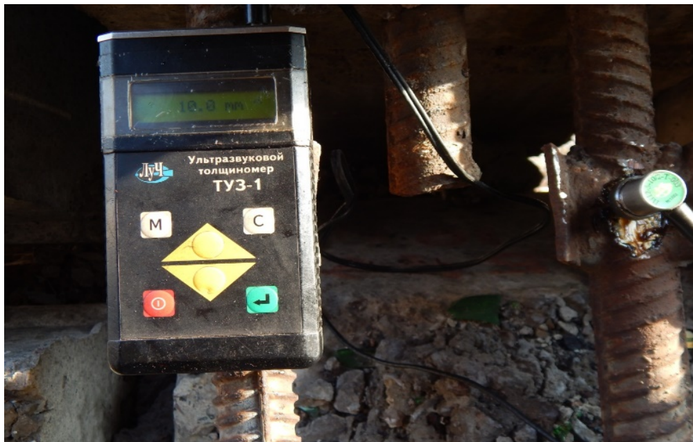
Рис. 2. Виявлення внутрішніх дефектів зварного шва в з'єднанні колони і ригеля по осі 19 ряд А/1 на відмітці +6,000, стержень правий (Ф-2)
