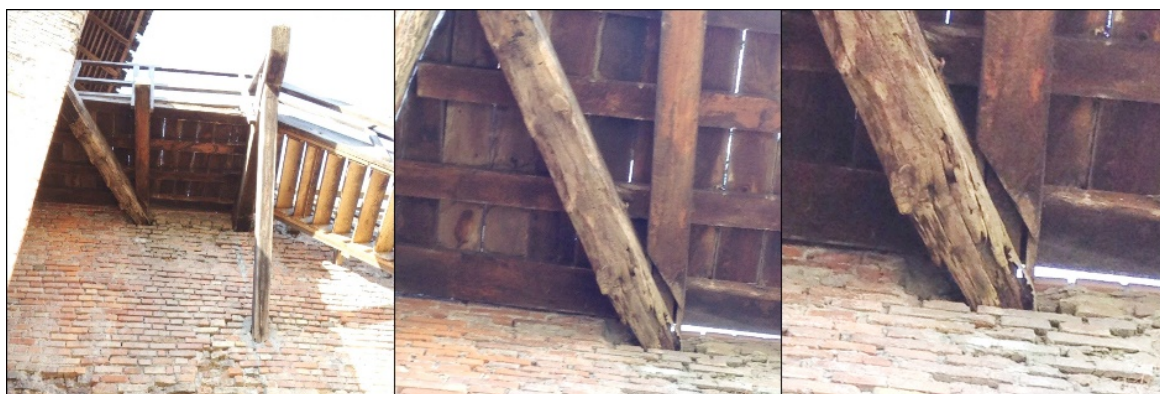
Рис. 1. Часткова зруйнованість балок в конструкціях сходів
