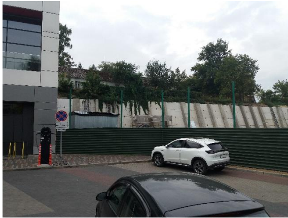
Рис. 2. Вигляд на південний схил, укріплений залізобетонною стіною з контрфорсами, урборельєфу ділянки рекреаційної зони у долині річки Сапалаївки, станом на вересень 2024 року (авторське фото)
