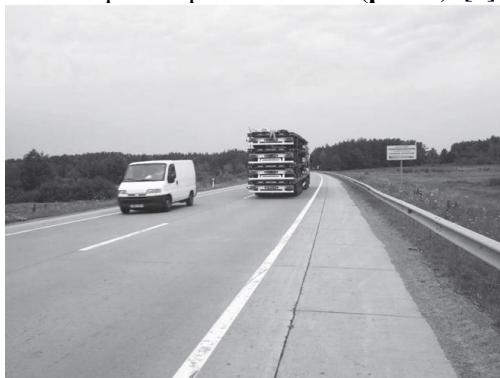
Рис. 1. Вигляд автодороги із цементобетонним покриттям Київ-Ковель після більш як 10 років експлуатації
