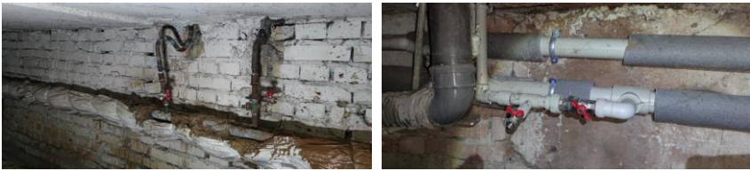
Рис. 1. Стан утеплення трубопроводів
