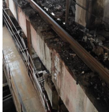
Рис. 5. Сколи у верхній полиці залізобетонної підкранової балки
