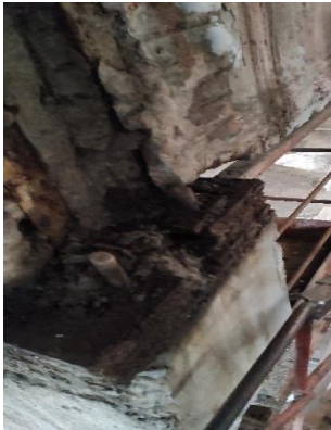
Рис. 2. Руйнування бетону полиць підкранових балок з оголенням та корозією арматури
