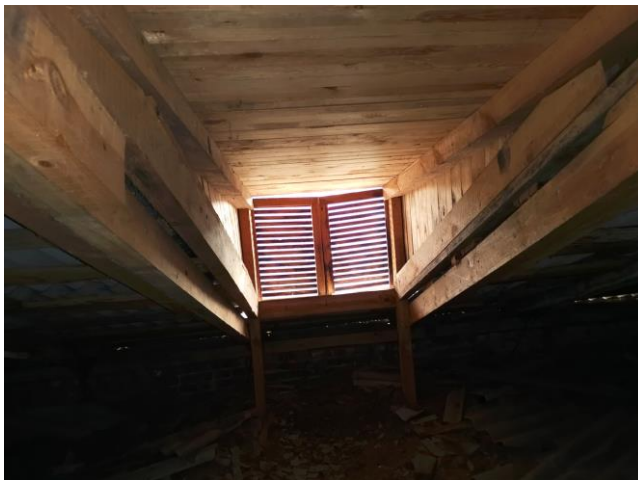
Рис.2. Стан несучих конструкцій житлового будинку після тривалої експлуатації
