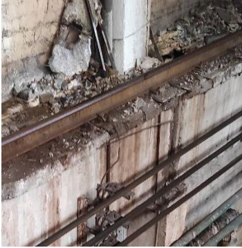
Рис. 4. Сколи у верхній полиці залізобетонної підкранової балки
