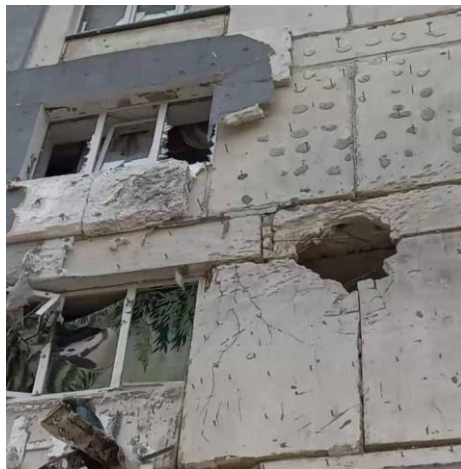
Рис. 11. Помилки при утепленні пінополістиролом
