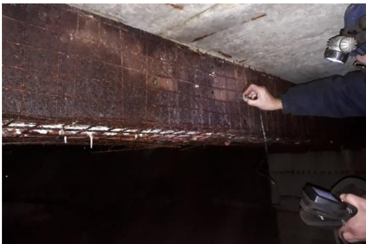
Рис. 4. Проведення дефектоскопічного ультразвукового контролю корозійних втрат металевих балок перекриття
