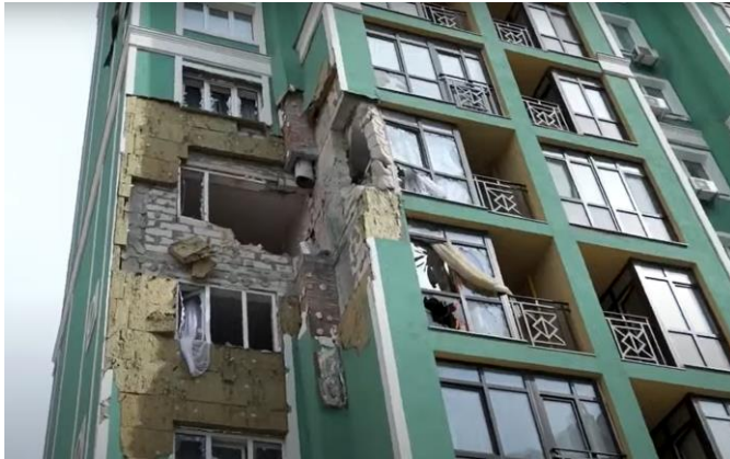
Рис. 8. Будівля, утеплена базальтовою ватою з помилками
