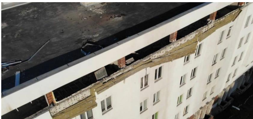
Рис. 9. Будівля, утеплена базальтовою ватою з помилками
