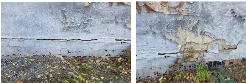
Рис. 4. Горизонтальна розвинена тріщина розкриттям до 2 см
