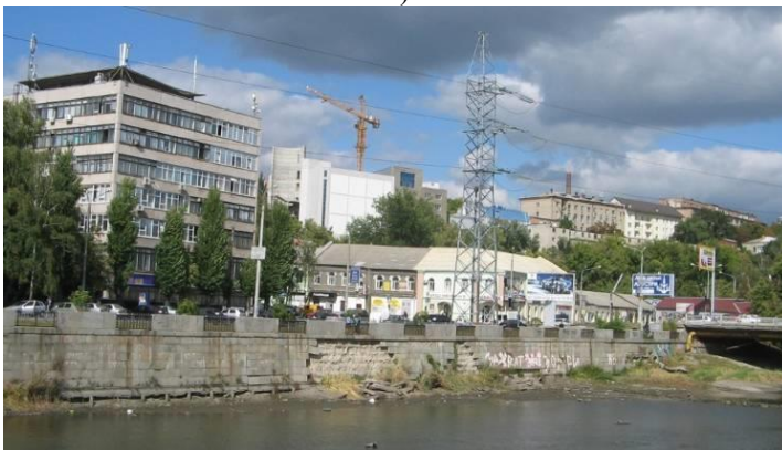
Рис. 1. Участки разрушенной облицовки на Харьковской набережной р. Харьков в г. Харькове: а – возле Харьковского моста; б – у моста Чигирина
