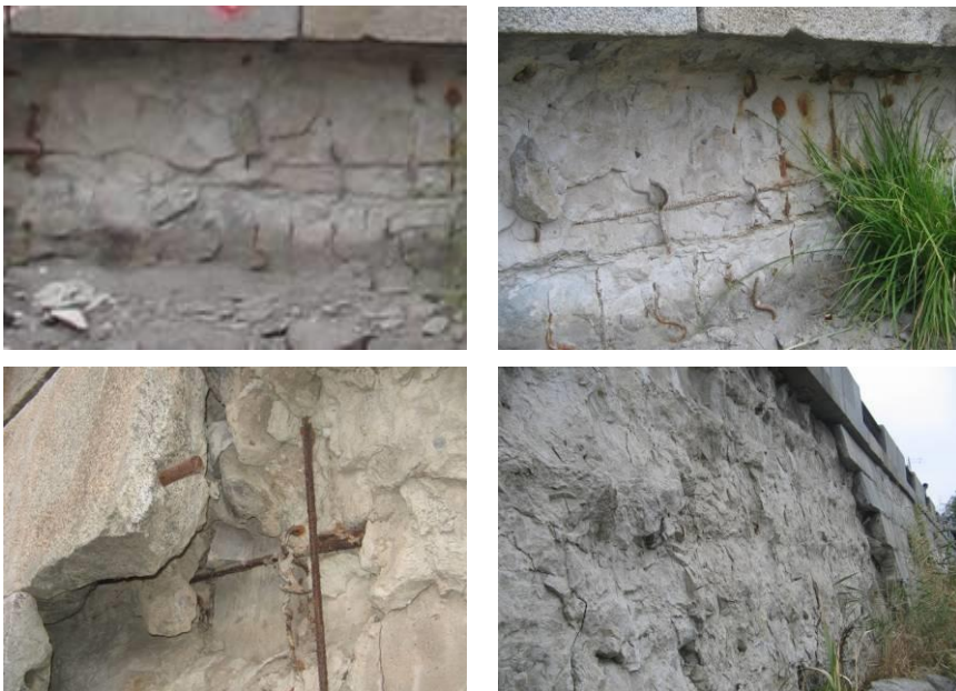
Рис. 2. Увеличенные фрагменты повреждений в местах разрушенной облицовки возле опоры ЛЭП у моста Чигирина
