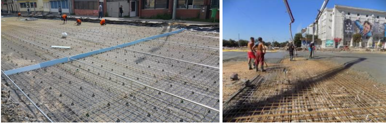
Рис. 3. Збір армокаркасу дорожньої цементобетонної плити основи по вул. Клочківська, м. Харків з композитних георешіток з влаштуванням термодеоформаційних швів із подальшим бетонуванням
