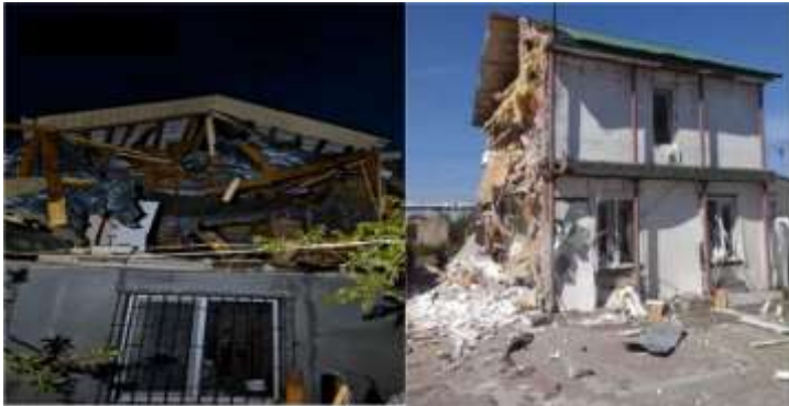
Рис. 1. Загальний вигляд пошкодженого будинку, що розглядається як об'єкт реконструкції та модернізації інженерного обладнання
