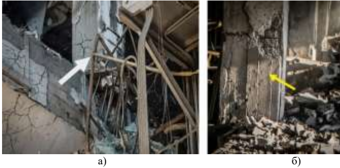
Рис. 1. Характерні пошкодження залізобетонної колони після вибухового впливу: а – локальне руйнування перерізу з горизонтальним зміщенням осі колони на 300 мм, з випучуванням поздовжньої арматури та повним оголенням стрижнів; б – система вертикальних і похилих тріщин з розкриттям у зоні максимальних згинальних деформацій.
