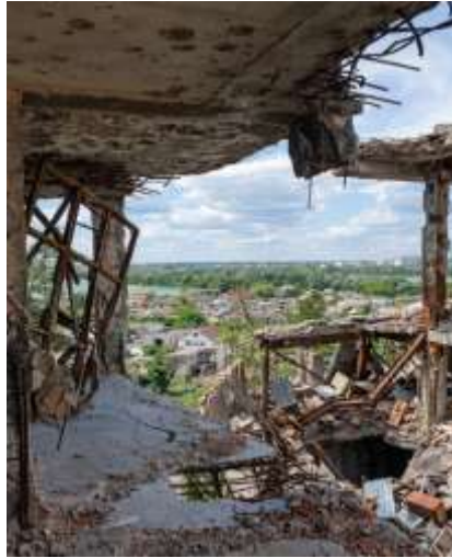
Рис. 3. Характерні пошкодження плит перекриття та вертикальних елементів каркаса після вибухового та ударного навантаження
