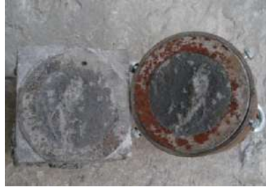
Рис. 9. Зовнішній вигляд, після розриву поверхні шорсткого бетону і торкретбетону
