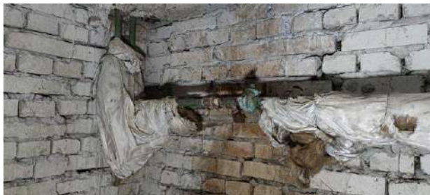
Рис. 2. Стан значної кількості існуючих трубопроводів
