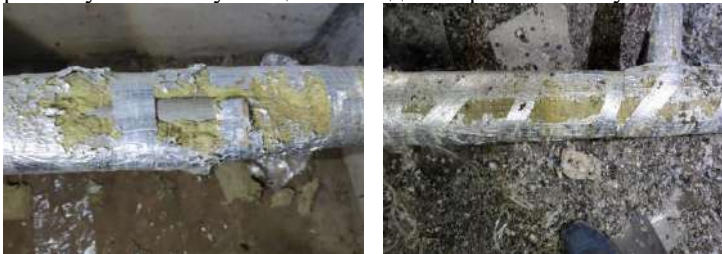
Рис. 5. Ушкодження шару утеплювача
