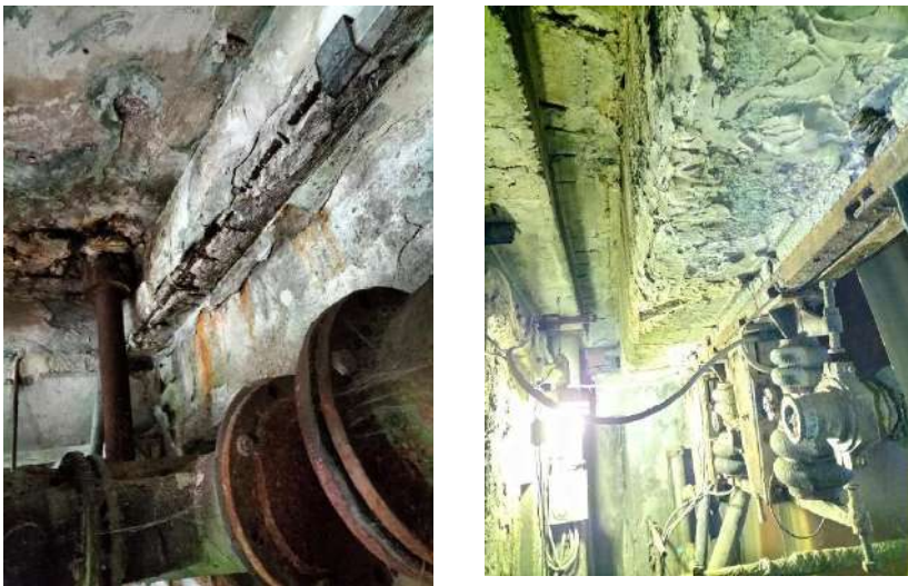
Рис. 2. Фотофіксації з обстеження шинної балки
