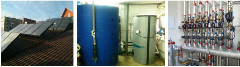
Рис. 1. Практичний досвід: сонячні колектори і теплові насоси для систем опалення та гарячого водопостачання готелю (м. Луцьк)
