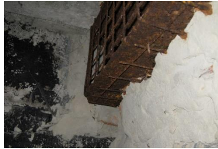
Рис. 6. Ексцентричне розміщення, змяття опорної частини фундаменту металевої балки 2 Т №27Са – ряд Е, вісь 29
