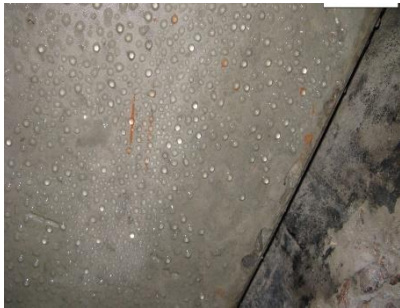
Рис. 2. Надмірна вологість середовища, конденсат на плитах перекриття підвалу (ряди В-Г, осі 29 – 30)
