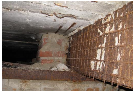
Рис. 3. Корозія металевих балок і арматури з/б плит перекриття
