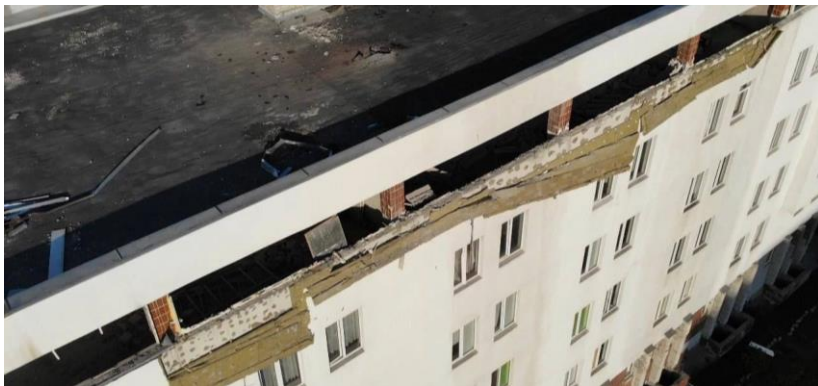
Рис. 9. Будівля, утеплена базальтовою ватою з помилками
