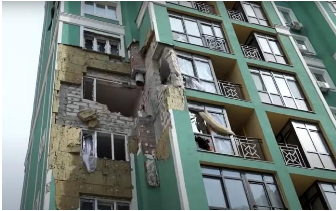
Рис. 8. Будівля, утеплена базальтовою ватою з помилками
