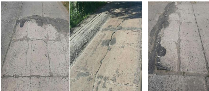
Рис. 1. Пошкодження поверхні покриття автомобільної дороги після 25 років експлуатації
