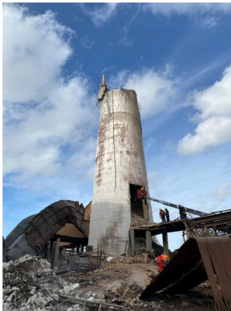
Рис. 4. Загальний вигляд зруйнованої димової труби
