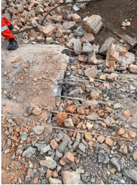
Рис. 5. Зруйнована частина димової труби
