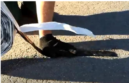
Рис. 5. Бітумна стрічка для тріщин
