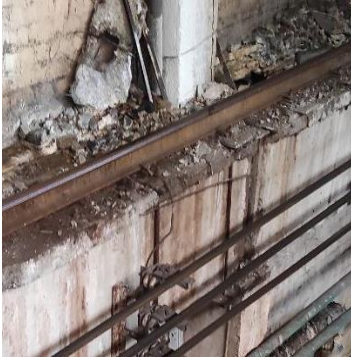
Рис. 4. Сколи у верхній полиці залізобетонної підкранової балки
