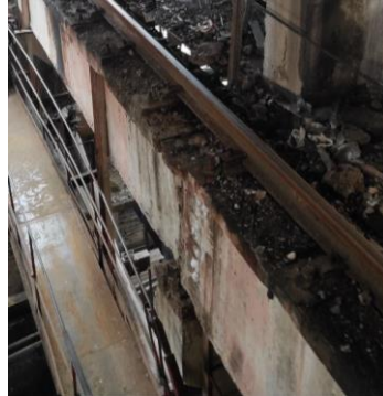
Рис. 5. Сколи у верхній полиці залізобетонної підкранової балки
