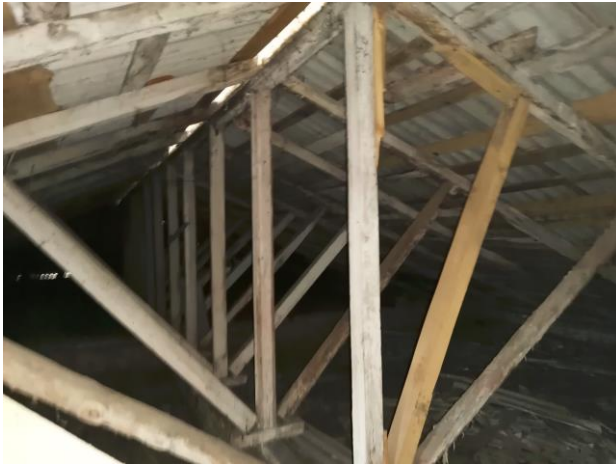
Рис.1. Стан крокв'яної системи адміністративного приміщення після тривалої експлуатації
